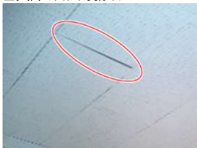
□天井のズレ、剥がれ
