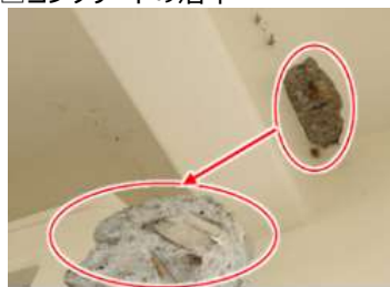
□コンクリートの落下
