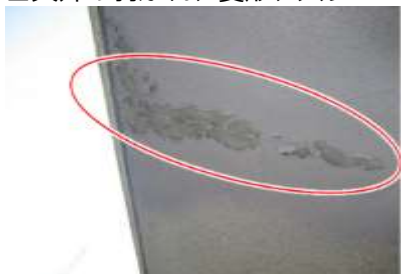
□天井の剥がれ、変形、ズレ
