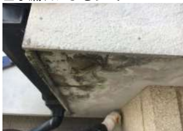
□水漏れによるシミ
