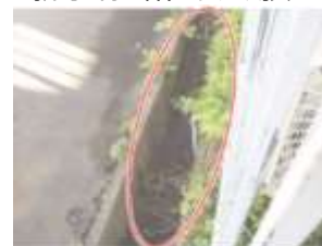
排水溝の詰まり、破損
