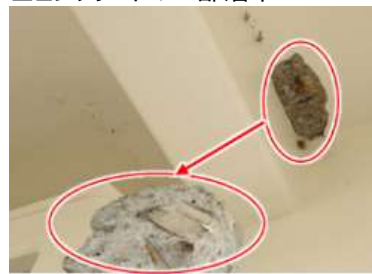
□コンクリートの一部落下
