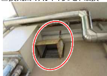
□換気口のズレ、ぐらつき、破損
