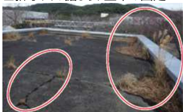
□排水口の詰まり、笠木の固定
