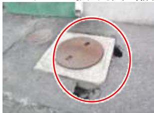
マンホール破損、周囲の陥没
