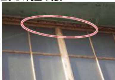
サビの発生・腐食
