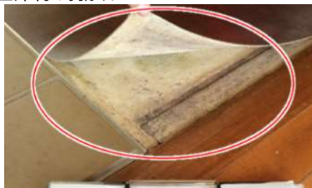
□床材の剥がれ
