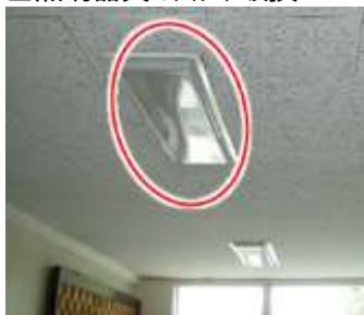
□照明器具のズレ、破損
