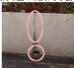
よう壁の破損、ひび割れ
