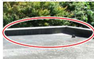
□パラペットのひび割れ、浮き、破損
