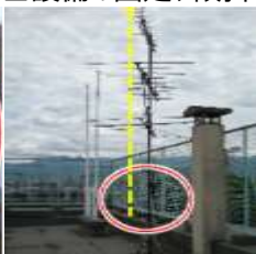
□設備の固定、傾斜
