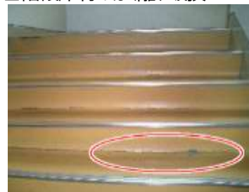
□階段床材のはく離、破損
