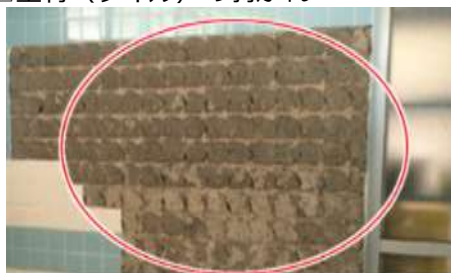
□壁材 (タイル) の剥がれ
