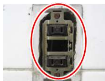
□コンセントの破損、ほこり
