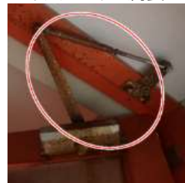
ドアクローザの腐食
