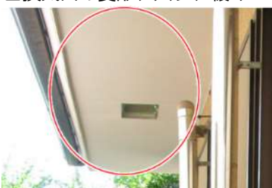
□換気口の変形、ズレ、緩み
