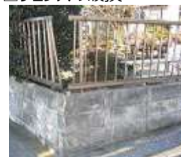
フェンスの破損
