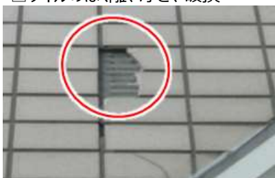
□タイルのはく離、浮き、破損
