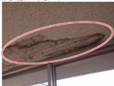
□水漏れによるシミ
