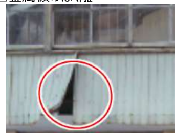
□金属板のはく離
