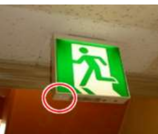
□誘導灯表示板の点灯確認
