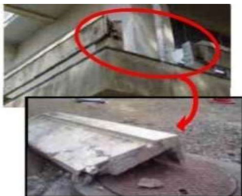
ベランダ手摺の落下
