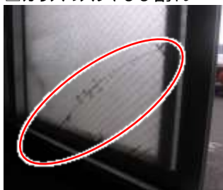
ガラスのズレ、ひび割れ
