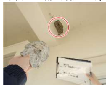
□天井のひび割れ、剥がれ、破損
