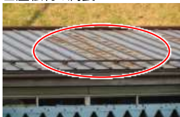
□屋根材の腐食
