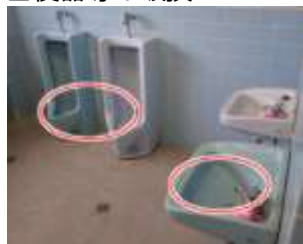
□便器等の破損
