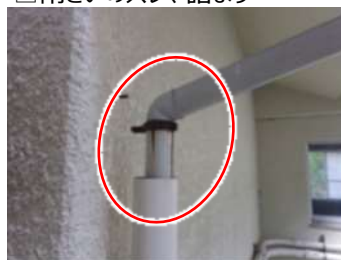
□雨どいのズレ、詰まり
