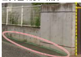
よう壁の沈下・傾斜
