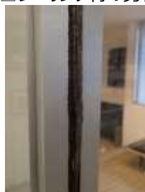
シーリング材の劣化
