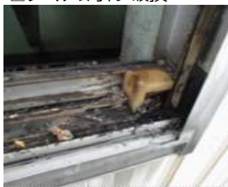
レールの汚れ・破損
