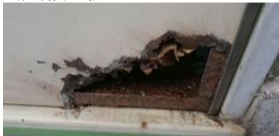
扉の腐食、破損
