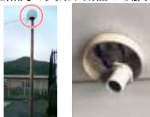
点灯の異常、機器の破損
